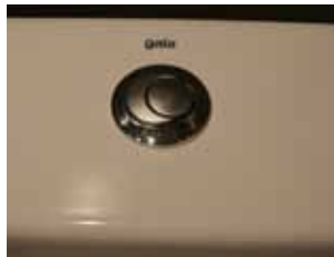
Mecanisme de doble càrrega als WC del càmping Tamariu.
