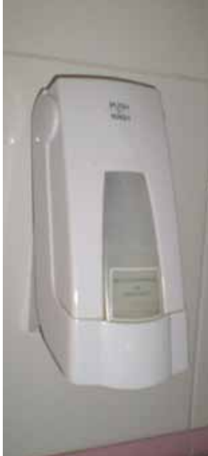
Dosificador de sabó a l'hotel Casamar.
